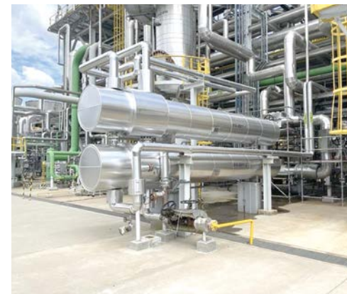
● Výmenníky tepla na prevádzke Čpavok 4
